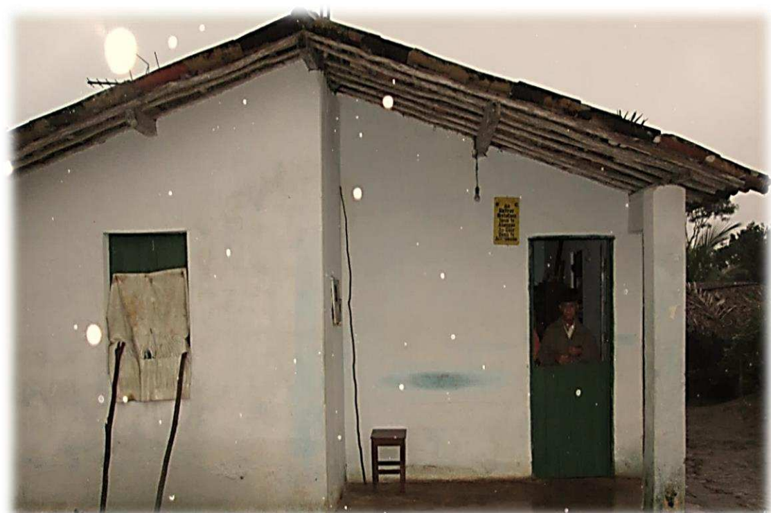
Uma das primeiras casas de alvenaria refeitas pela Chesfe,, meados de fim da década de 80
