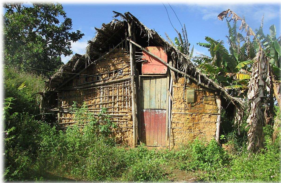
Casa de taipa abandonada por causa da estrutura precária
