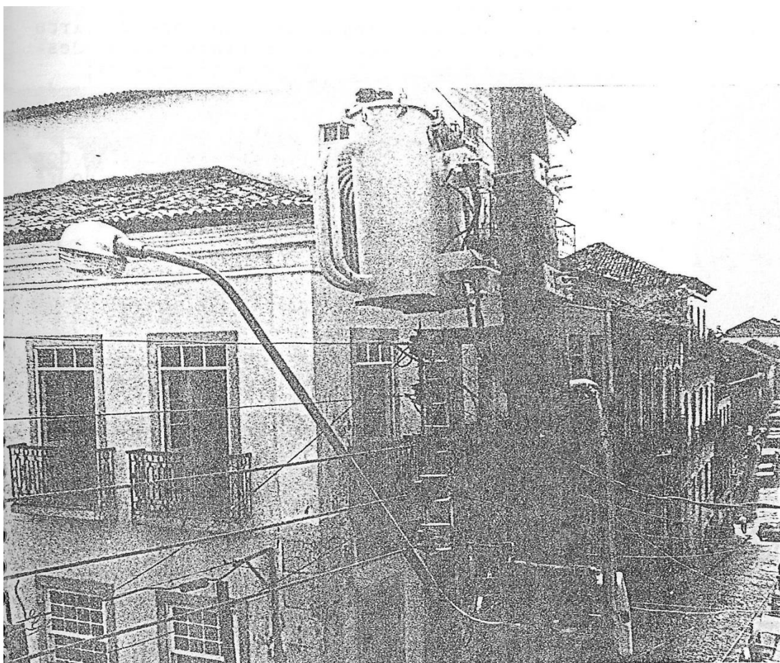
Figura 14 – Fiação elétrica aérea. Fonte: Maranhão, 1986, p. 86
