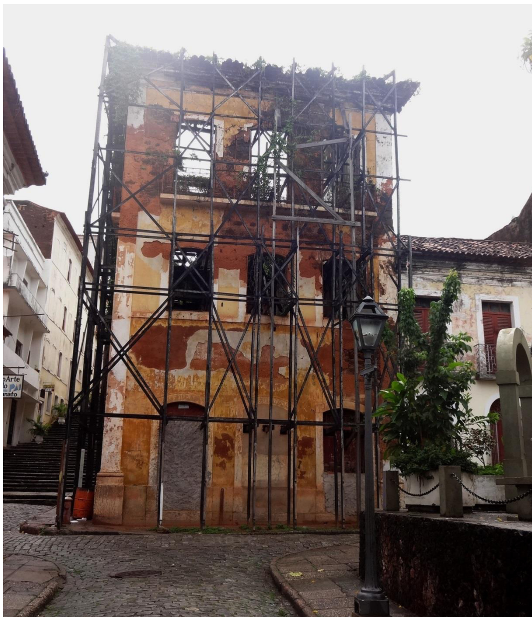
Figura 26 – Casarão em ruínas estabilizado. Fonte: Autoria própria
